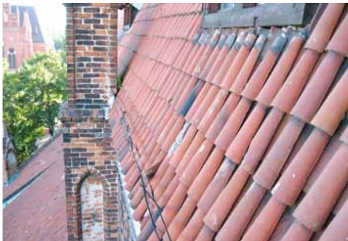
◀ Z daleka nie wyglądały źle, ale z bliska 100-letnie dachówki wykazywały jednak uszkodzenia
